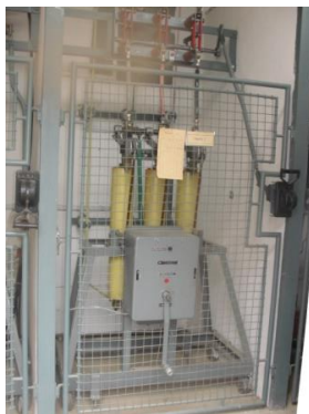
Slika broj 79. Transformator
