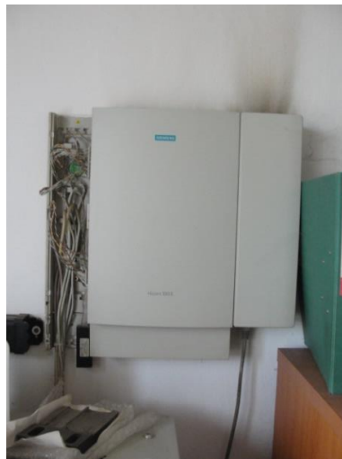
Slika broj 85. Telefonska centrala
